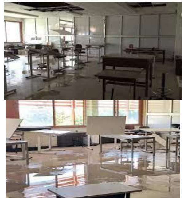
شكل 2: تسرب المياه من أسقف القاعات الدراسية بكلية الهندسة
